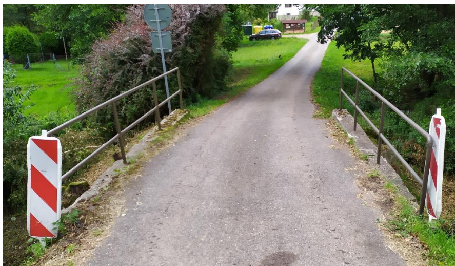
Obrázek 17: Most na místní komunikaci přes potok Maršovku vedoucí do lokality s místně zažitým názvem Zada – stav k srpnu 2021
