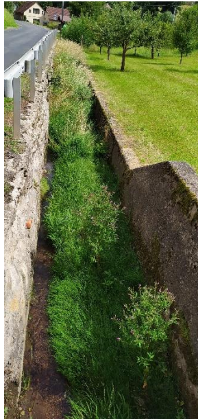
Obrázek 20: Koryto hlavního vodního toku v obci, Maršovky – stav k srpnu 2021
